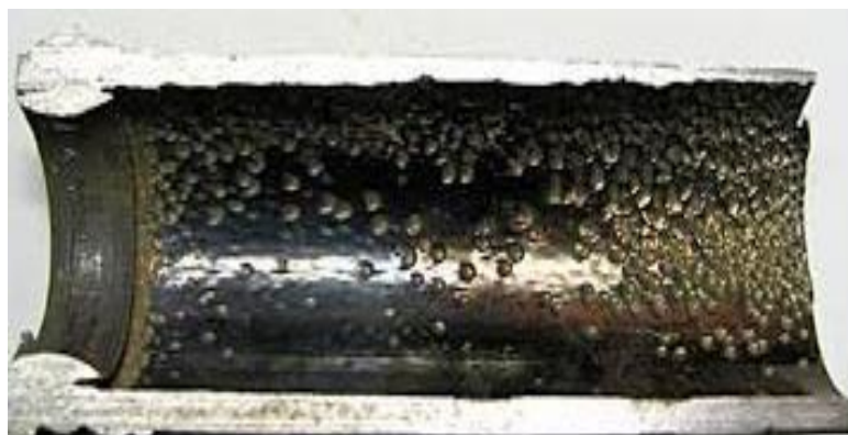
Figura 35: Corrosió d'un tub d'acer al carboni que pertany a un circuit d'una caldera de recuperació de calor. [36]
