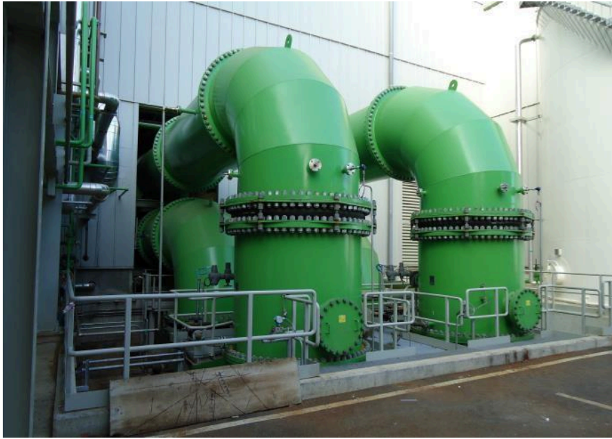
Figura 43: Canonades d'entrada i sortida d'aigua de circulació del condensador. FONT: Endesa Generació S.A.
