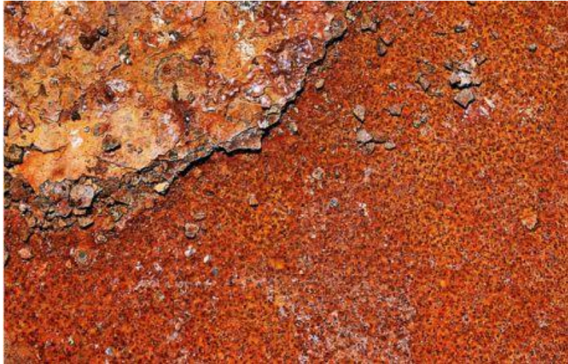
Figura 20: Corrosió en el ferro.[23]
