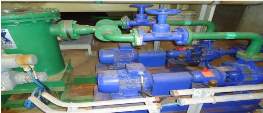
Figura 51: Sistema de neteja de brutícia dels tubs del condensador. FONT: Endesa Generación S.A.
