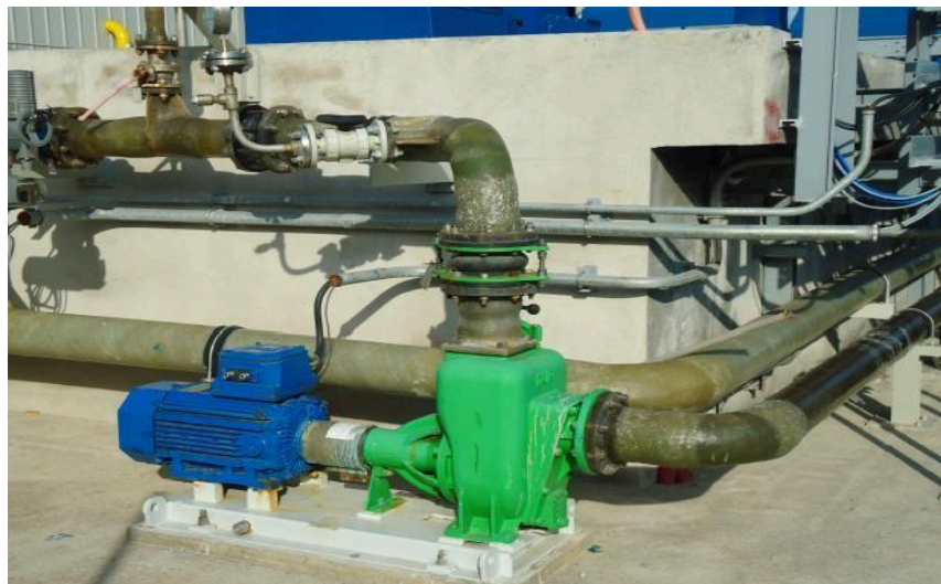
Figura 45: Bomba d'ompliment. FONT: Endesa Generació S.A.
