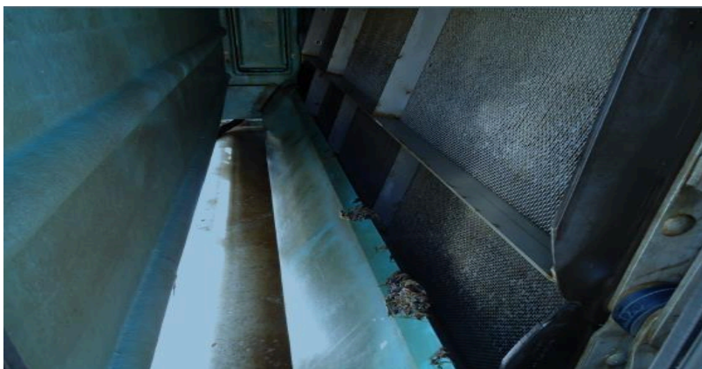
Figura 47: Sistema de filtratge mòbil d'aigua de circulació. FONT: Endesa Generació S.A.
