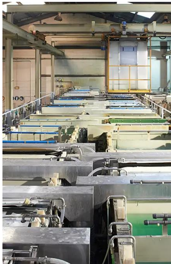
Ilustración 8.3: Instalaciones de Elhco. Fuente: [23]
