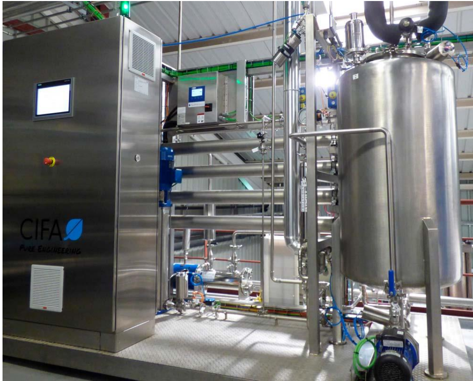
Ilustración 8.2: Instalaciones de CIFA. Fuente: [22].
