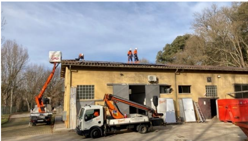
Figura 7.1.3.1 Exemple de la instal·lació d'un sistema FV en una coberta (Desembre 2022)
