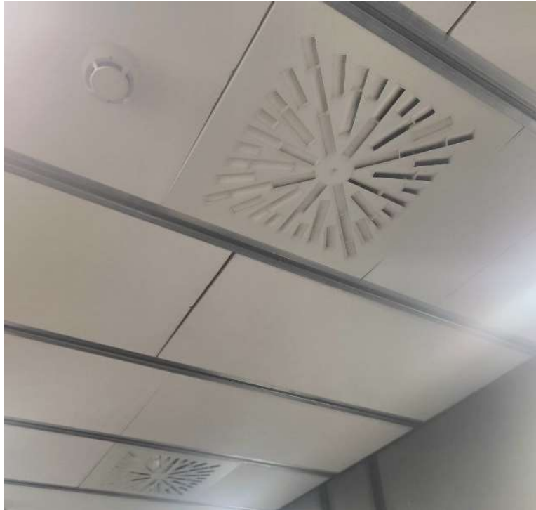
Fig. 5.5. Aire condicionat de la sala de l'assaig de soroll
