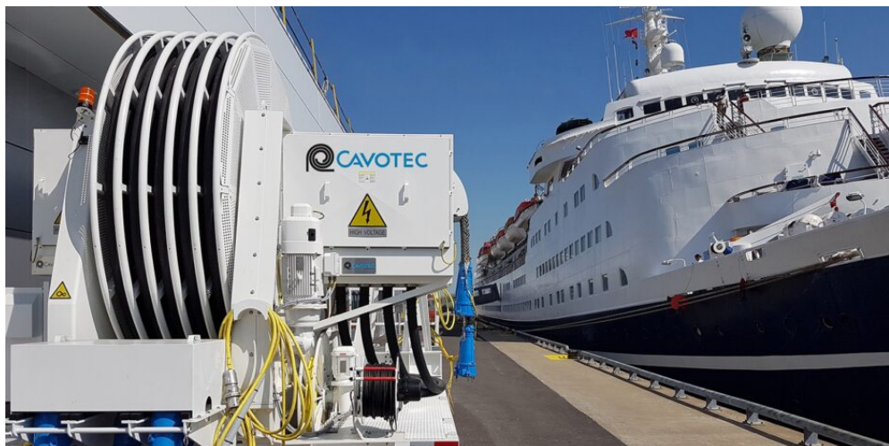
Ilustración 6 Conexión para dar electricidad a un buque atracado Fuente: Cavotec
