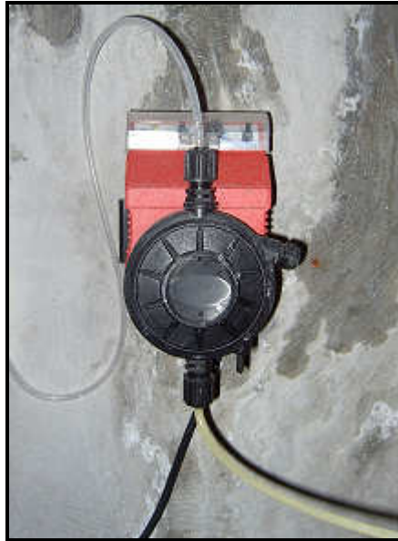
Fig.3.2 Bomba injecció clor.
