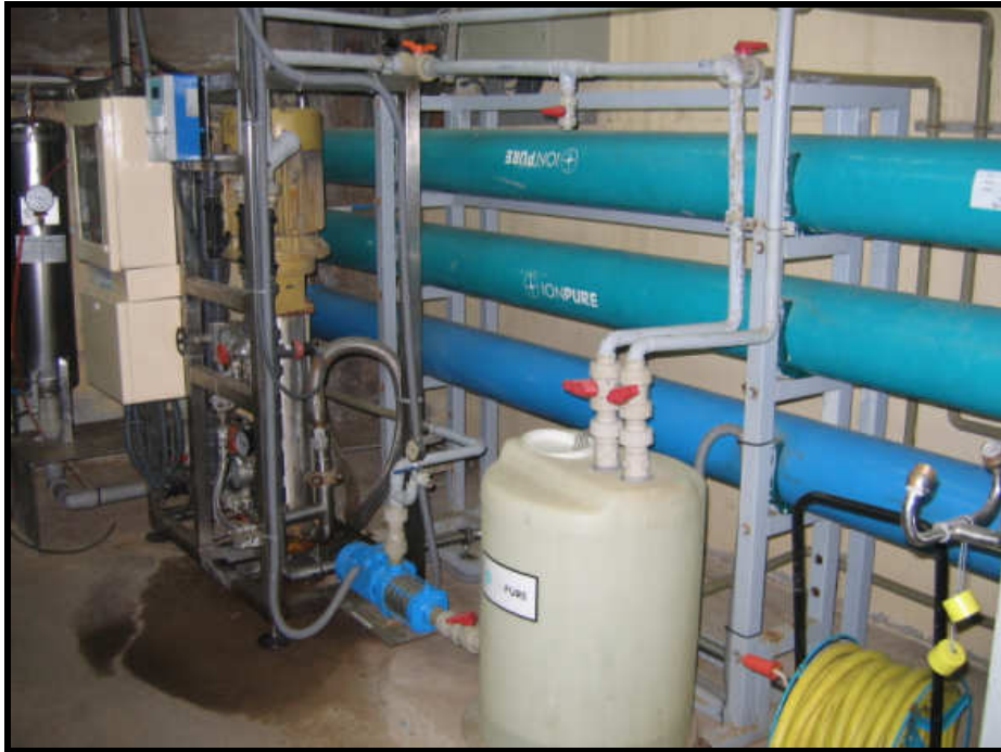
Fig.3.5 Osmosi inversa de Fresenius Kabi.
