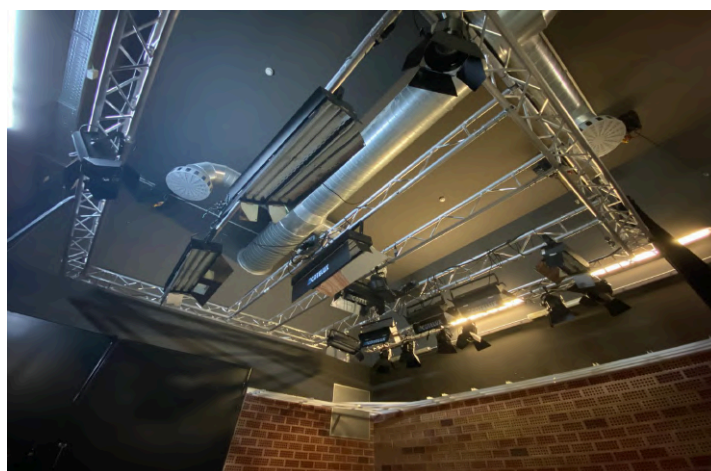
Fig. 6.5. Set de luces en truss A de plató.
