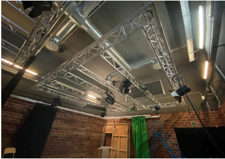
Fig. 6.6. Set de luces en truss B de plató.
