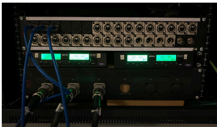
Fig. 6.7. Rack con conexiones de microfónica y de cámaras de plató.
