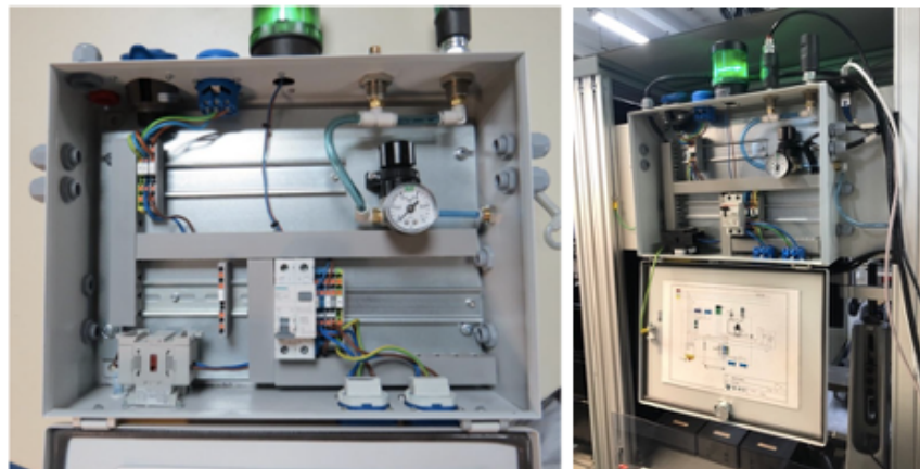
Figura 5.3. Cuadro eléctrico (Fuente: propia)
