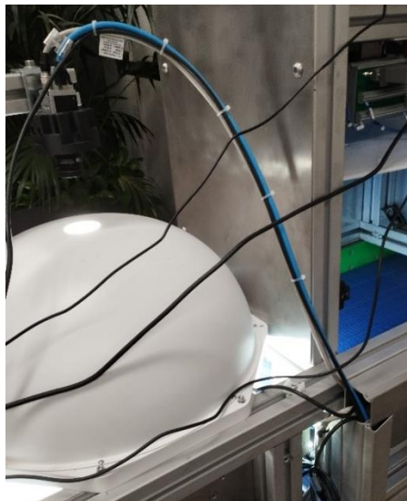
Figura 8.3.14. Cables recollits del dom d'il·luminació. Font pròpia
