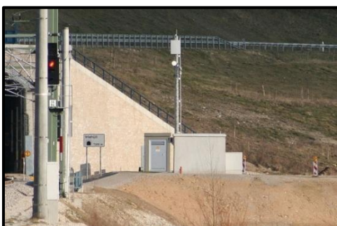
Figura 3.1.1.6 - Estació de telecomunicació GSM-R (Font: Wikipedia - Article "GSM-R")
