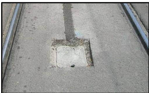
Figura 3.2.4.3 - Balisa ATP a les vies (Font: www.tramvia.org )
