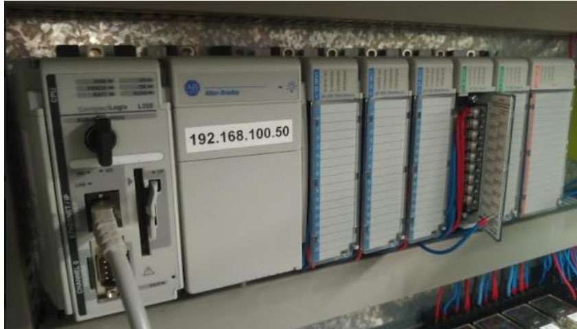
Figura 4.1.11. Compactlogix 1769-L32E [Fuente propia]
