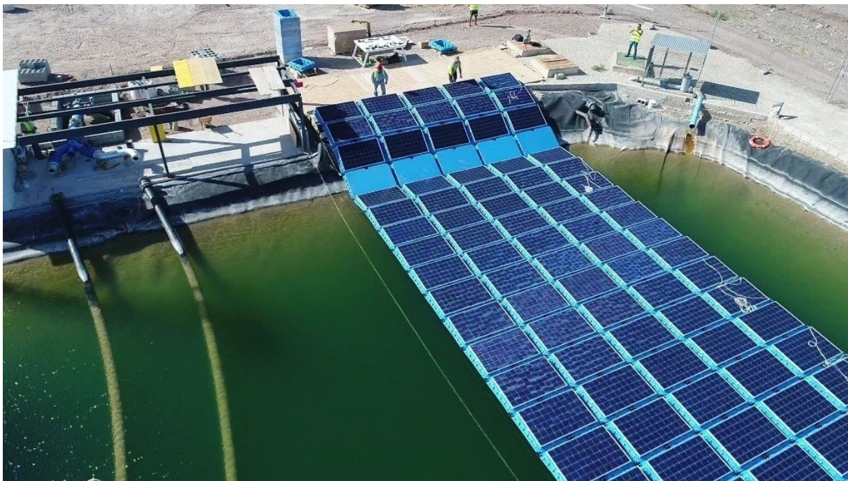
Fig. 8.10 Muntatge real d'instal·lació fotovoltaica flotant (Font: Google Imatges).
