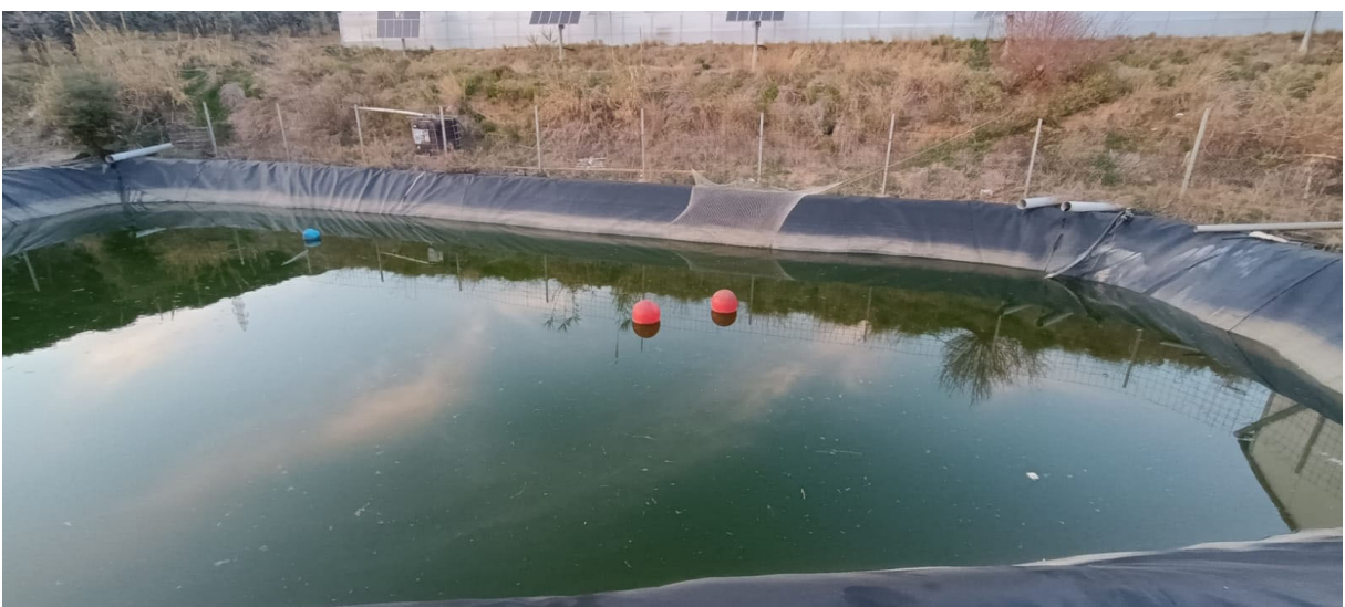
Fig. 8.1 Imatges reals de la bassa objecte de la instal·lació
