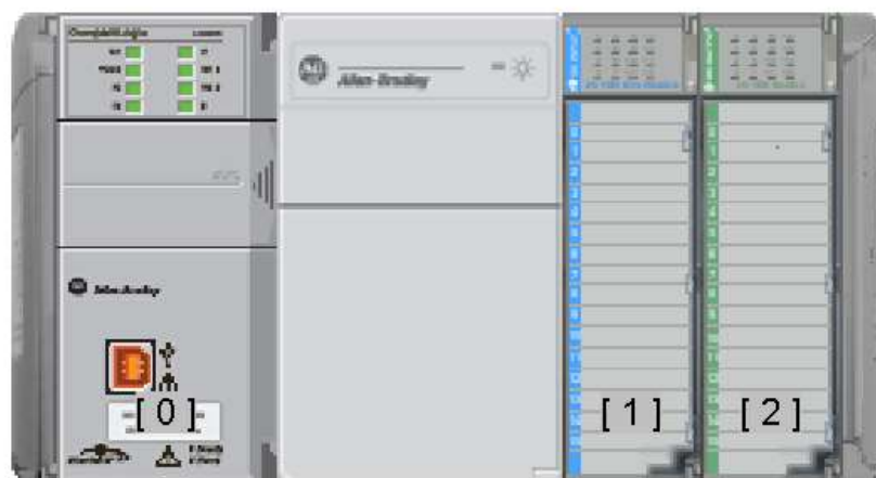
Fig. 3.2. CompactLogix. Font: Elaboració pròpia
