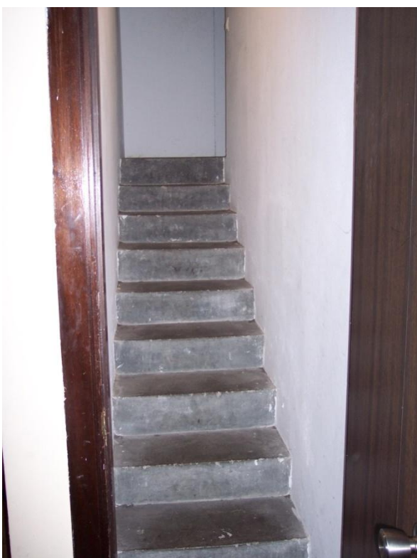
Ilustración LXI. Escalera a cabina de control
