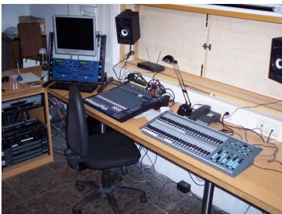
Ilustración XXXII. Cabina de control
