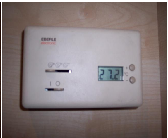
Ilustración LVII. Control aire acondicionado
