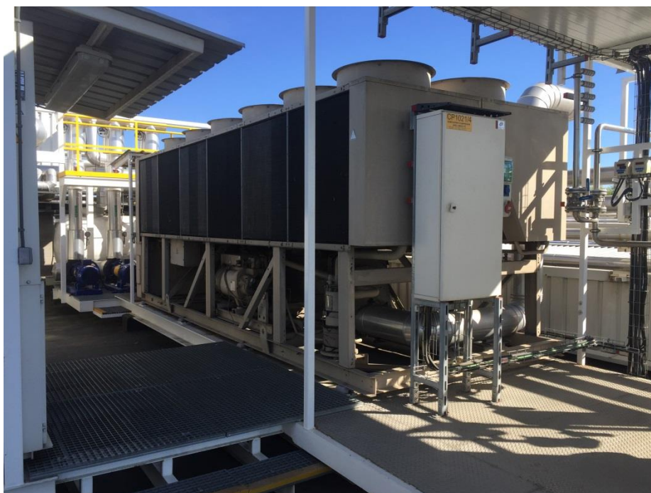
Figura 2-4: Enfriadora Trane 1 Fuente: Grifols S.A
