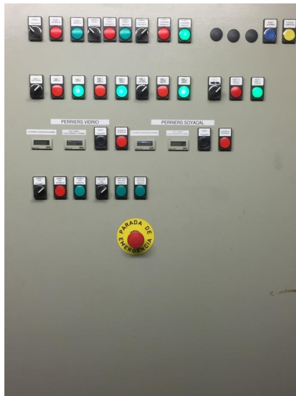
Figura 2-12: Cuadro actual de control de la instalación Fuente: Grifols S.A
