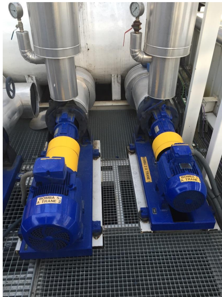
Figura 2-9: Bombas de recirculación Fuente: Grifols S.A
