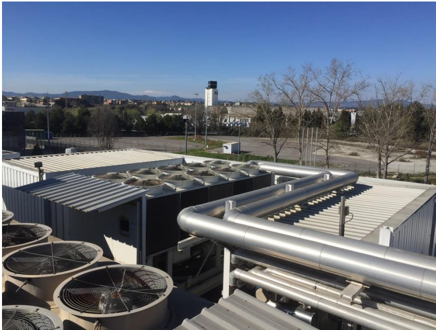
Figura 2-8: Enfriadora Trane 2 Fuente: Grifols S.A
