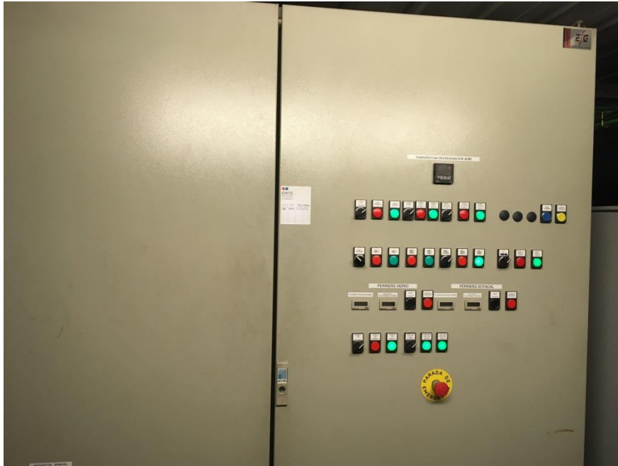
Figura 2-11: Cuadro actual de control de la instalación Fuente: Grifols S.A
