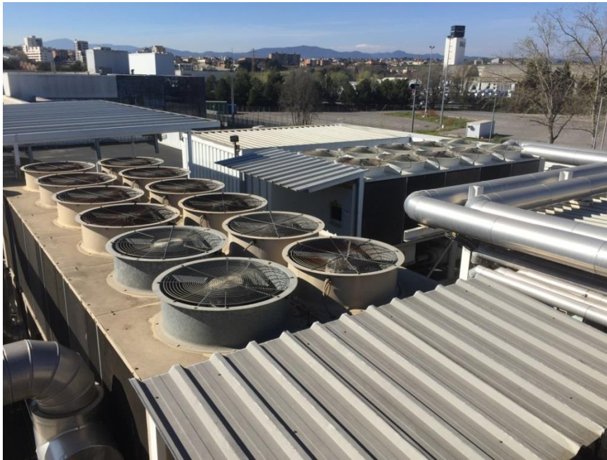
Figura 2-5: Enfriadora Trane 1 Fuente: Grifols S.A
