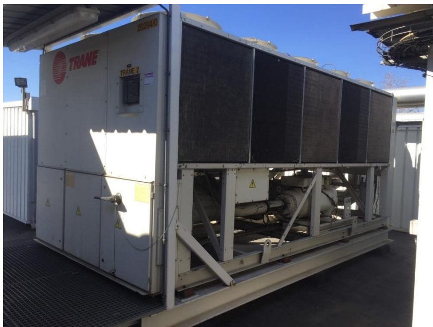
Figura 2-6: Enfriadora Trane 2 Fuente: Grifols S.A
