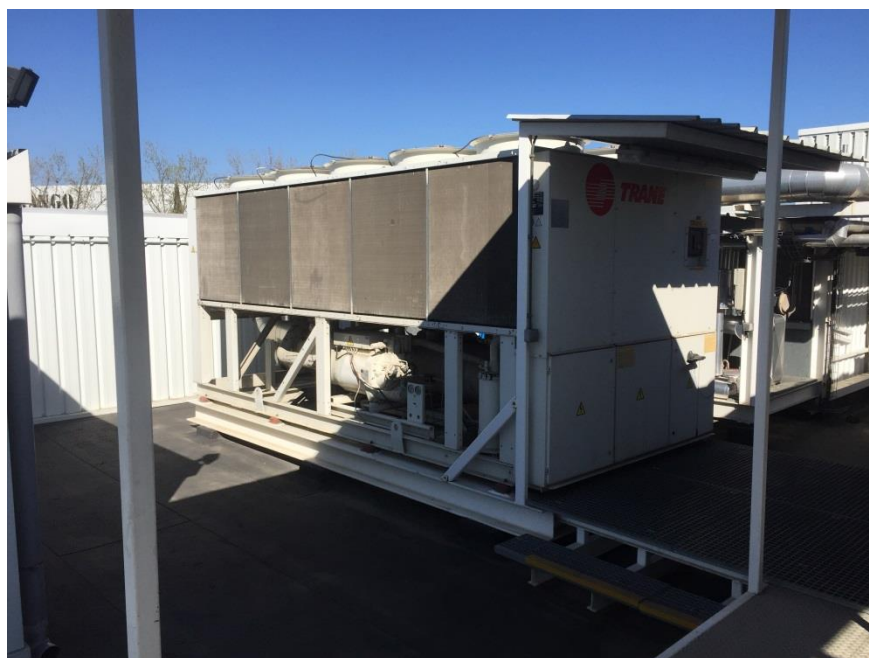
Figura 2-7: Enfriadora Trane 2 Fuente: Grifols S.A
