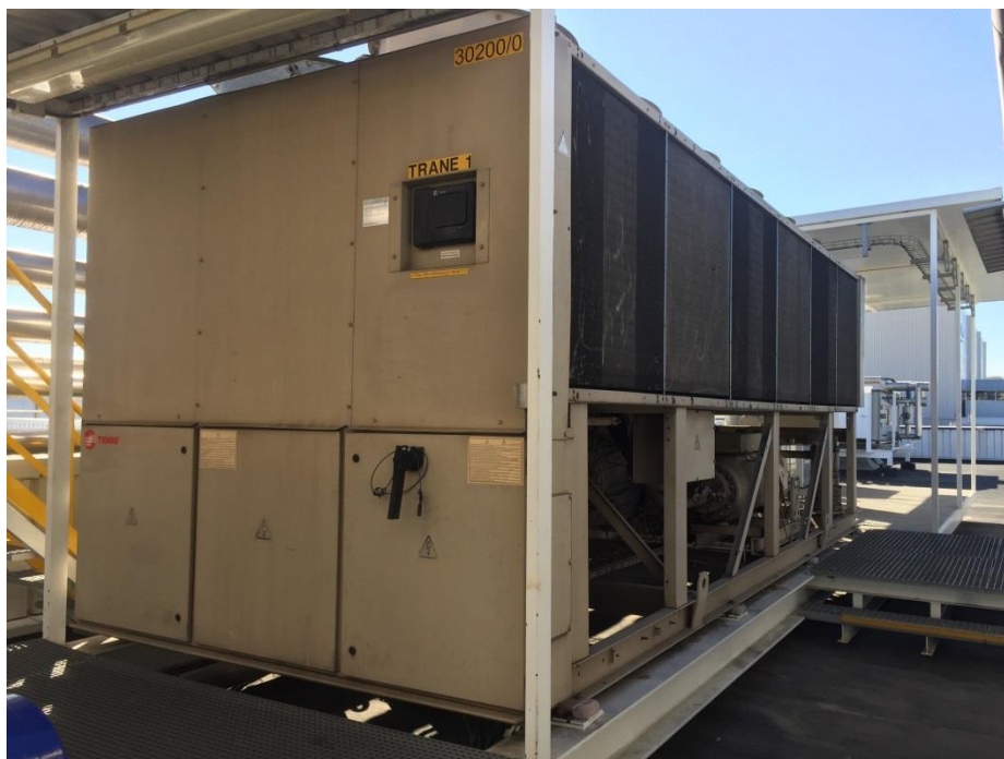
Figura 2-3: Enfriadora Trane 1 Fuente: Grifols S.A
