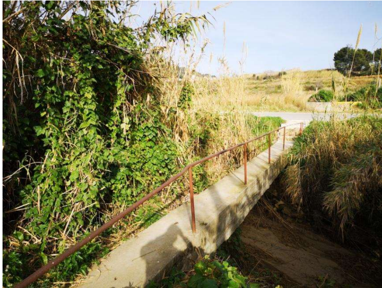
Figura 2.2: Pont antic a derruir.
