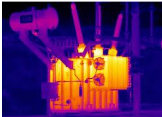
Fig. 2.6 Termografia a subestació transformadora (Font: Blog Termografias Marton)
