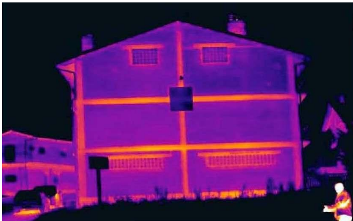
Fig. 2.11 Termografia de façana d'edifici mostrant ponts tèrmics (Font: Enrique Alario)
